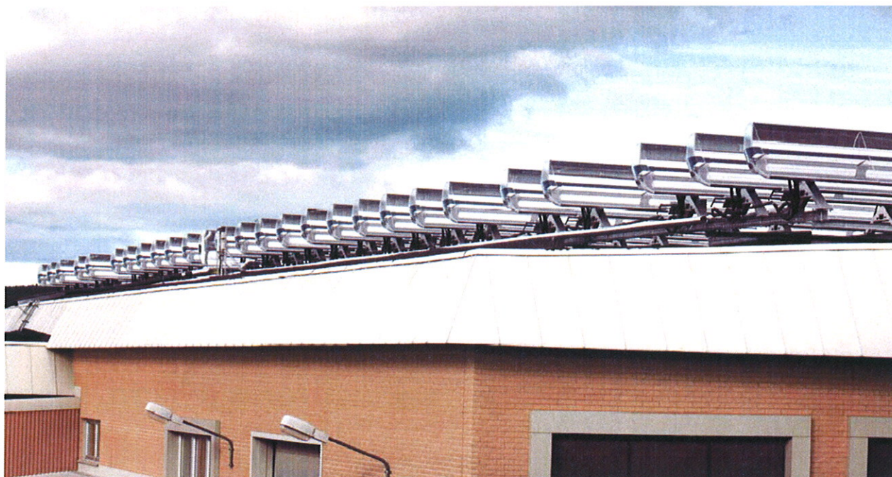
Gudlav Bilderskolan i Sollefteå har 270 m 2 av Absolicon koncentrerande solfångare som levererar värme till bygganden och till fjärrvärmenätet samt el till fastigheten.
