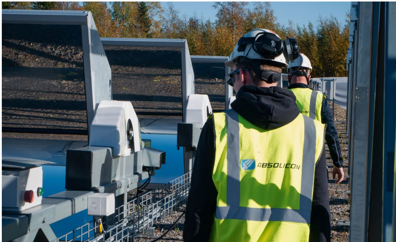
Servicearbete på Högslätten Solar Thermal Park i Härnösand. Foto: Erik Björkland
