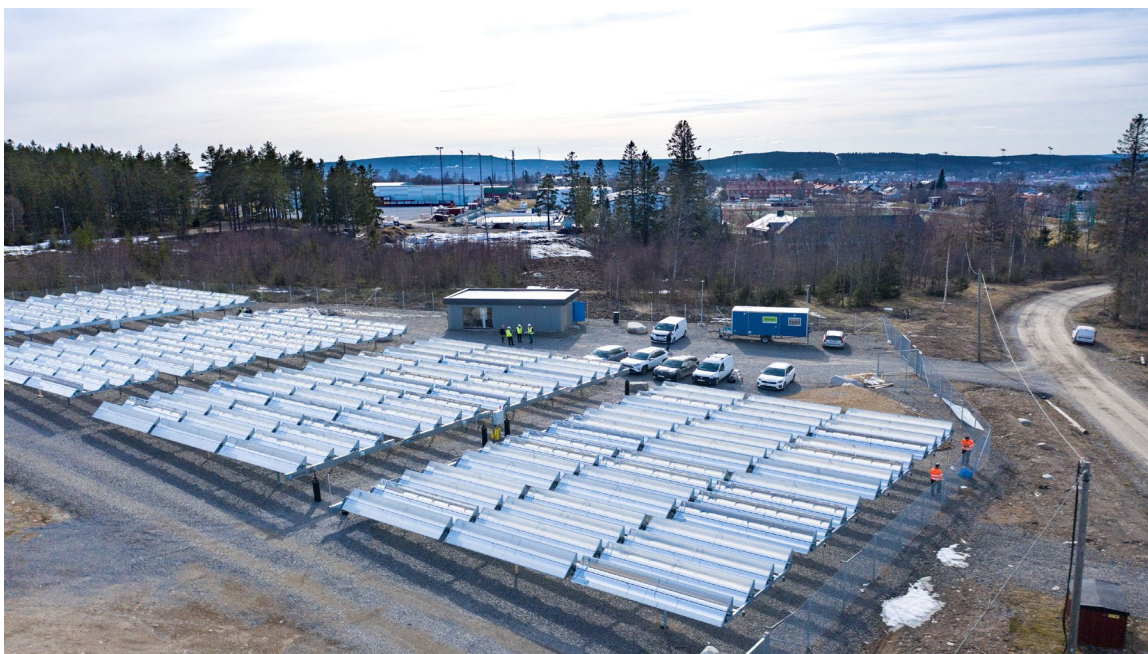
Solvärmepark som matar in upp till 110 °C fjärrvärme i Härnösands fjärrvärmenät
