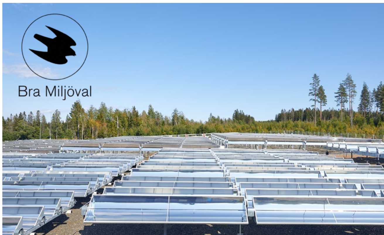
Absolicons solvärmeanläggning, Högsåten Solar Thermal Park i Härnösand.
